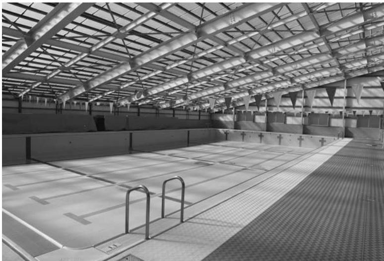
▶老朽化が進んでいる町民水泳プール
