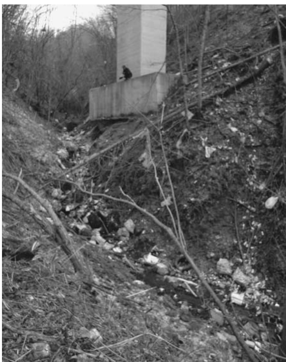
▶不法投棄の現場。橋の上から投げ落としているようです
