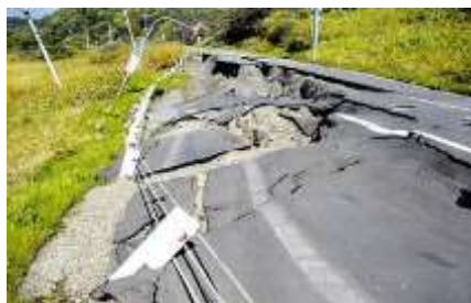
平成 15 年十勝沖地震（豊頃町）
